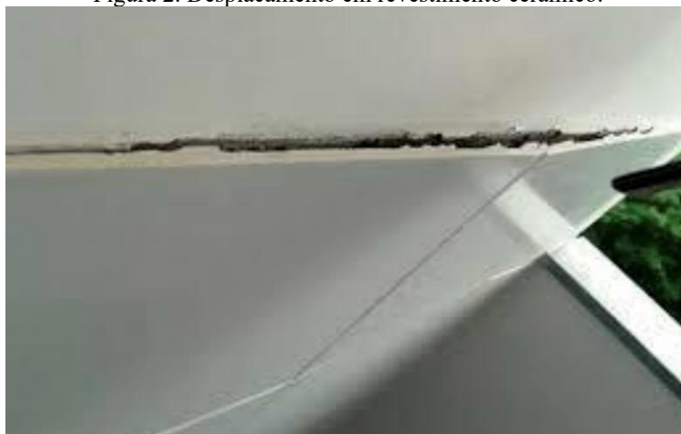
Figura 2. Deslocamento em revestimento cerâmico.
