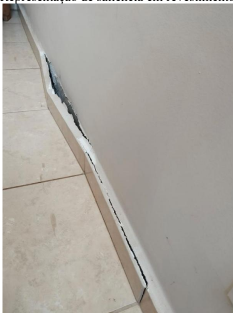
Figura 4. Representação de saliência em revestimento cerâmico.
