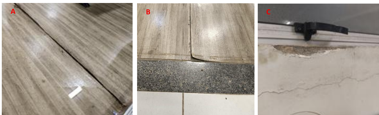
Figura 8. Patologias de infiltração e descolamento – IF Goiano - Campus Trindade – 2023.
