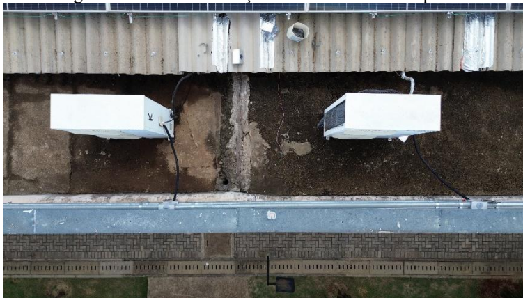
Figura 5. Patologias de mofos e infiltrações – IF Goiano - Campus Trindade – 2023.
