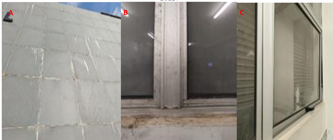
Figura 7. Patologias de eflorescência, mofo, bolor e empenamento das esquadrias – IF Goiano - Campus Trindade, 2023.
