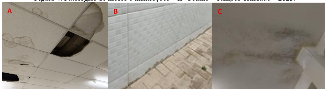
Figura 4. Patologias de mofos e infiltrações – IF Goiano - Campus Trindade – 2023.
