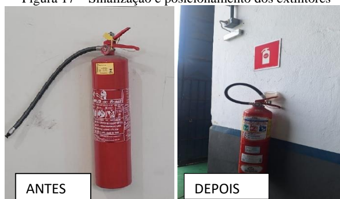
Figura 17 – Sinalização e posicionamento dos extintores
