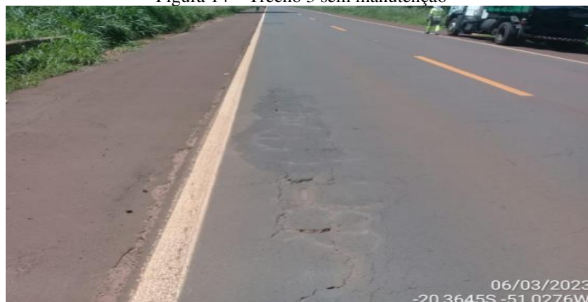
Figura 14 – Trecho 3 sem manutenção
