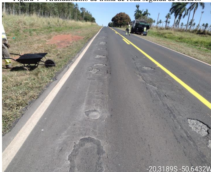
Figura 4 - Afundamento de trilha de roda seguida de buracos
