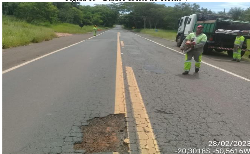
Figura 18 - Buraco aberto no Trecho 4
