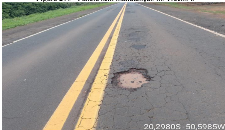
Figura 216 - Panela sem manutenção no Trecho 5
