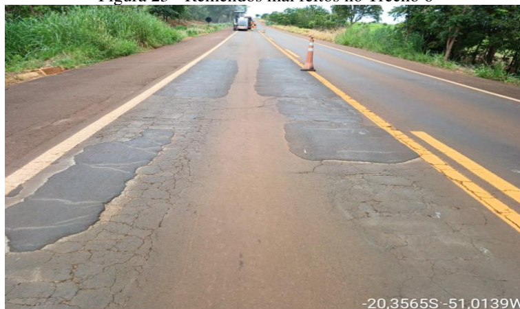
Figura 23 - Remendos mal feitos no Trecho 6
