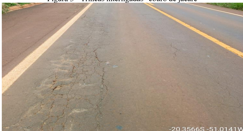
Figura 3 - Trincas interligadas “couro de jacaré”
