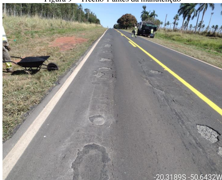
Figura 9 – Trecho 1 antes da manutenção
